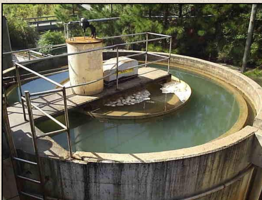
Depuradora de águas residuais.
